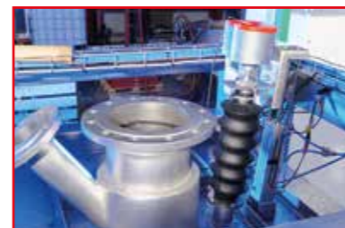
Mit Faltenbalg in einer Abfüllanlage für pulverförmiges Gefahrgut
